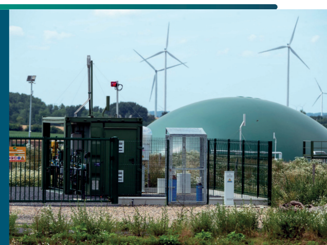
Figure 3 : Un poste biométhane, qui produit et injecte du gaz bas-carbone dans le réseau de gaz.
