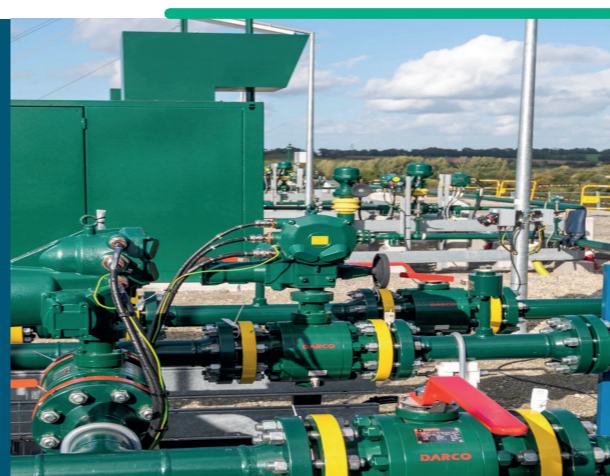
Figure 2 : Une interconnexion, carrefour du réseau de gaz.
